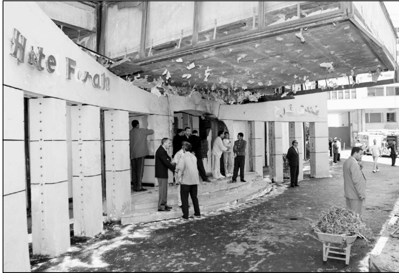
عمال يبدؤون بترميم فندق السيفري في الدار البيضاء إحدى البنايات المستهدفة في العمليات الانتحارية التي نفذت في المدينة المغربية ليلة الجمعة/السبت
