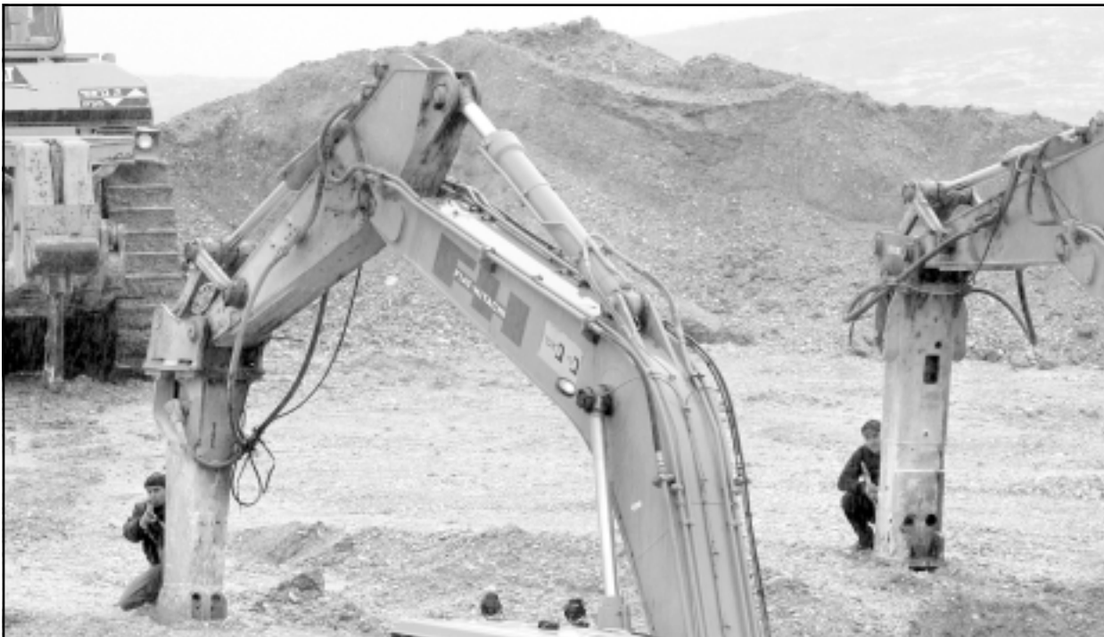
بلدوزرات اسرائيلية تحفر اراضي فلسطينية في قرية بيلين في الضفة الغربية تمهيداً لبناء الجدار العازل (ا ف ب)
