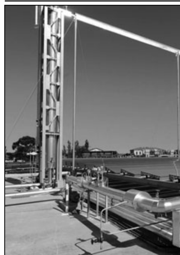
وحدة لتجميع وتركيز الطاقة الشمسية بغرض تسخين الماء وتوليد البخار اللازم لإدارة محطة توليد كهرباء. ومؤخرات تم تدشين هذه الوحدة التابعة لمجموعة سي. إن. إم. في مدينة لا سين سيرغز الفرنسية.
