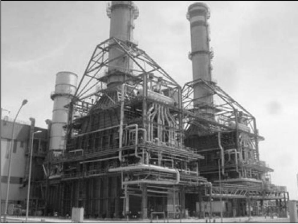
محطة توليد الكهرباء الكريما 2 محافظة المنوفية التي تبلغ قدرتها 750 ميغاواط. وتعمل الغاز والنظ وقد بدأ تشغيلها في وقت سابق من العام.
