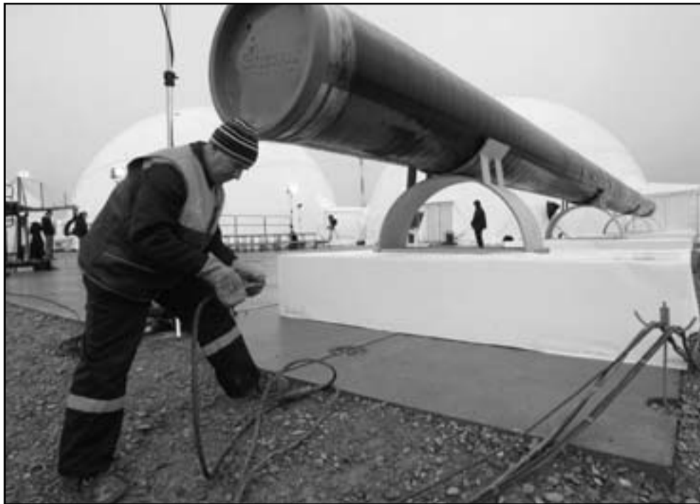
عامل يتفقد كابل كهربائياً قبل البدء بعملية لحام أول انبوبين من خط ساوث ستريم للغاز
