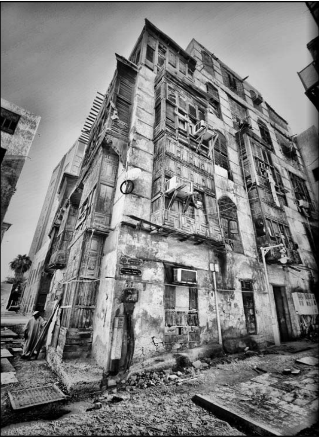
عمارة مهالكة بحاجة لترميم
