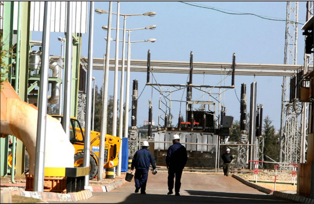
محطة كهربية غزة
