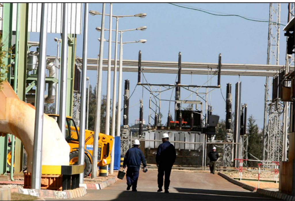
محطة كهرباء غزة
