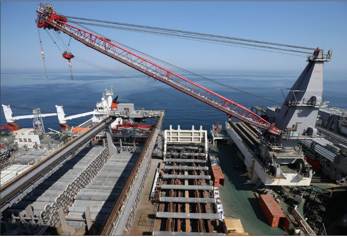
رافعة بعد انتهائها من انزال آخر أنبوب في خط أنابيب السيل التركي في المياه قرب اسطنبول
