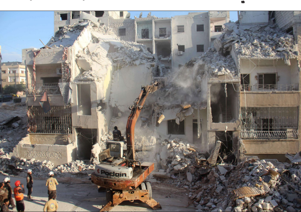
محاولة إنقاذ عالقين في أحد المباني المدمرة إثر قصف النظام لشمال غربي ادلب
