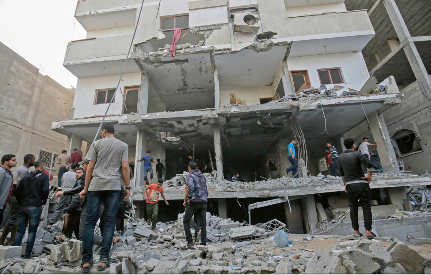
اثر الدمار على مبنى في غزة جراء القصف الإسرائيلي
