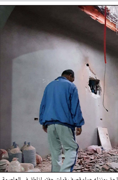
ليبي يتفقد آثار الدمار الذي لحق بمنزله جراء قصف قوات حفتر لمناطق في العاصمة
