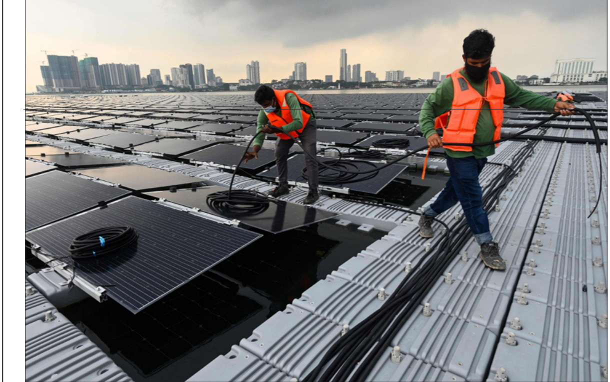
عمال يتفحصون الكوابل المرتبطة بالألواح الشمسية لمحطة التوليد الكهربائي العائمة في سنغافورة
