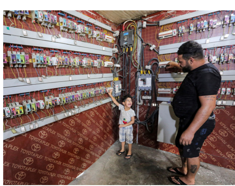
عقيل حسان وابنه الصغير مسلم داخل غرفة محولات التيار المولد الكهربائي المملوك له
