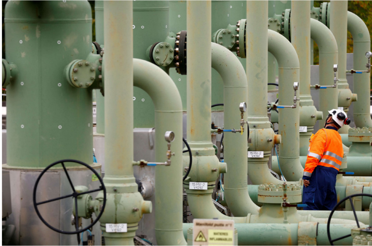
عامل يقرأ عدادات الضغط في الأنابيب الأرضية فوق خزان فرنسي للغاز يجري السحب منه لتزويد ألمانيا
