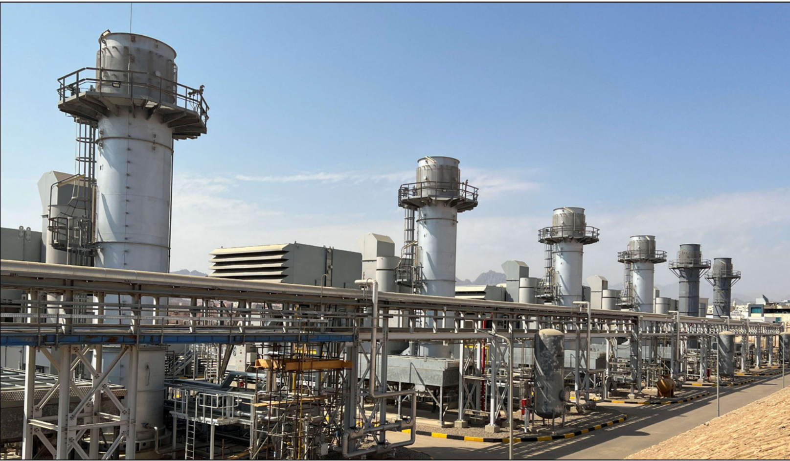
جانب من محطة توليد كهرباء في شرم الشيخ تدار جزئيا بوقود الهيدروجين الأخضر
