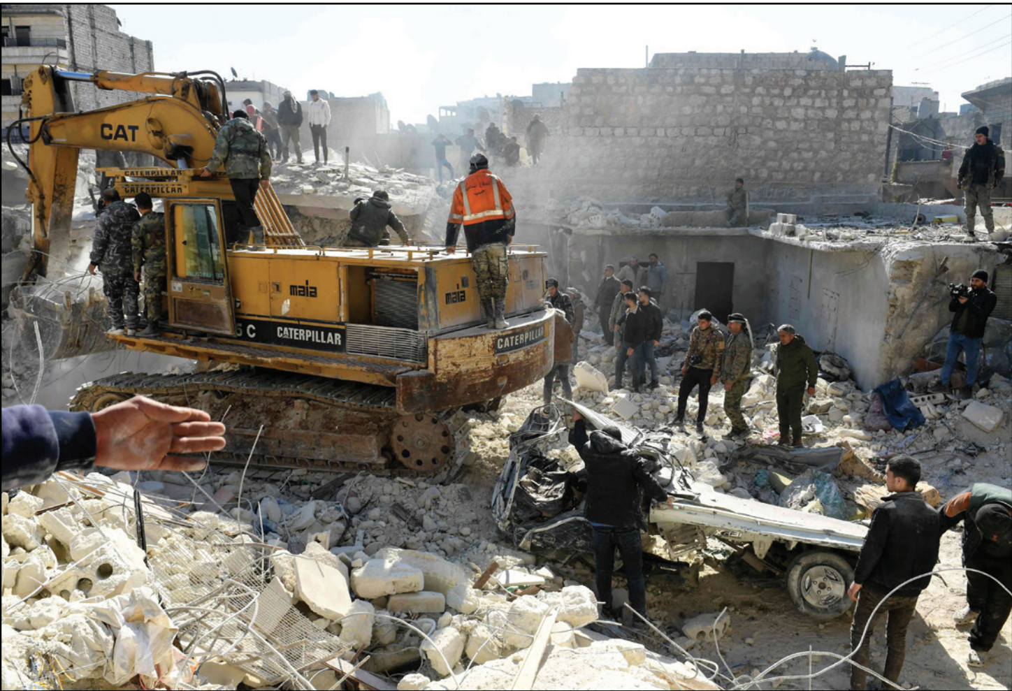
محاولات إنقاذ عالقين تحت ركام المبنى المنهار في حي الشيخ مقصود في حلب أمس
