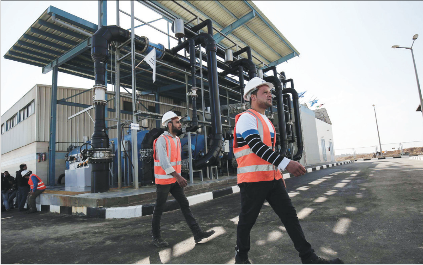
جانب من محطة تحلية مياه البحر بالطاقة الشمسية في دير البلح كأوسط قطاع غزة
